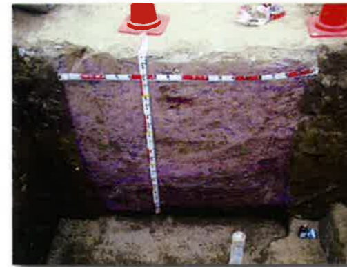
セメントのアルカリ反応 フェノールとセメントが反応し赤変した状況
